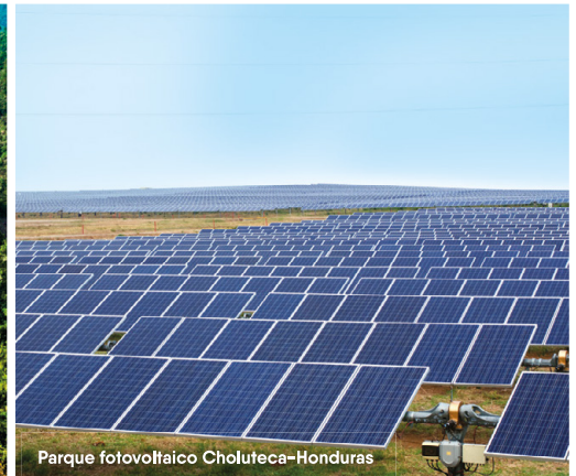
Parque fotovoltaico Choluteca-Honduras
